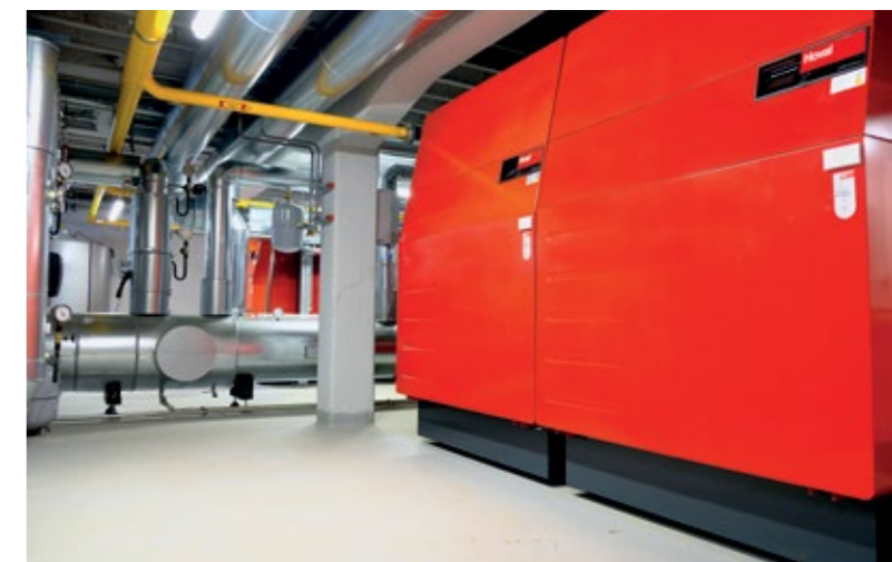
Die beiden Brennwertkessel UltraGas® (2000 D) erbringen eine Gesamthöchstleistung von 4 MW.
